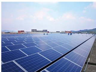
新能源综合自动化系统
