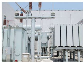
变电站综合自动化系统
